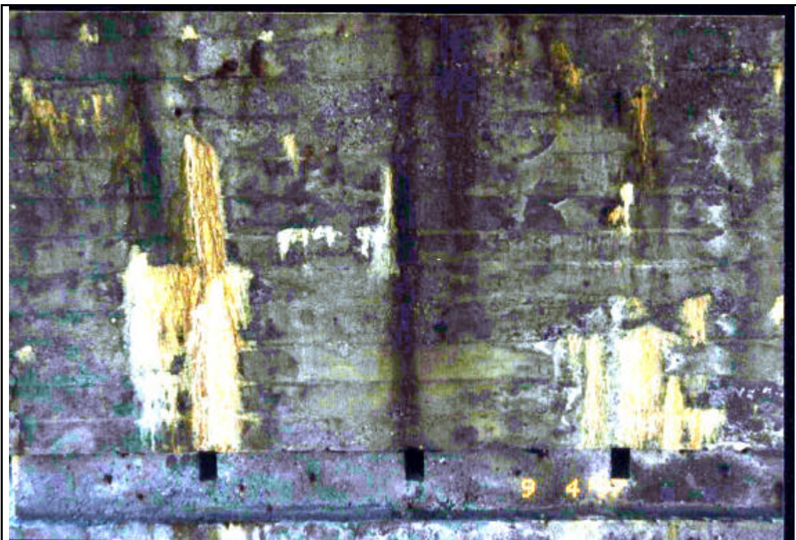
Fig. 2 - Corrosione, colature ed incrostazioni sul pulvino
