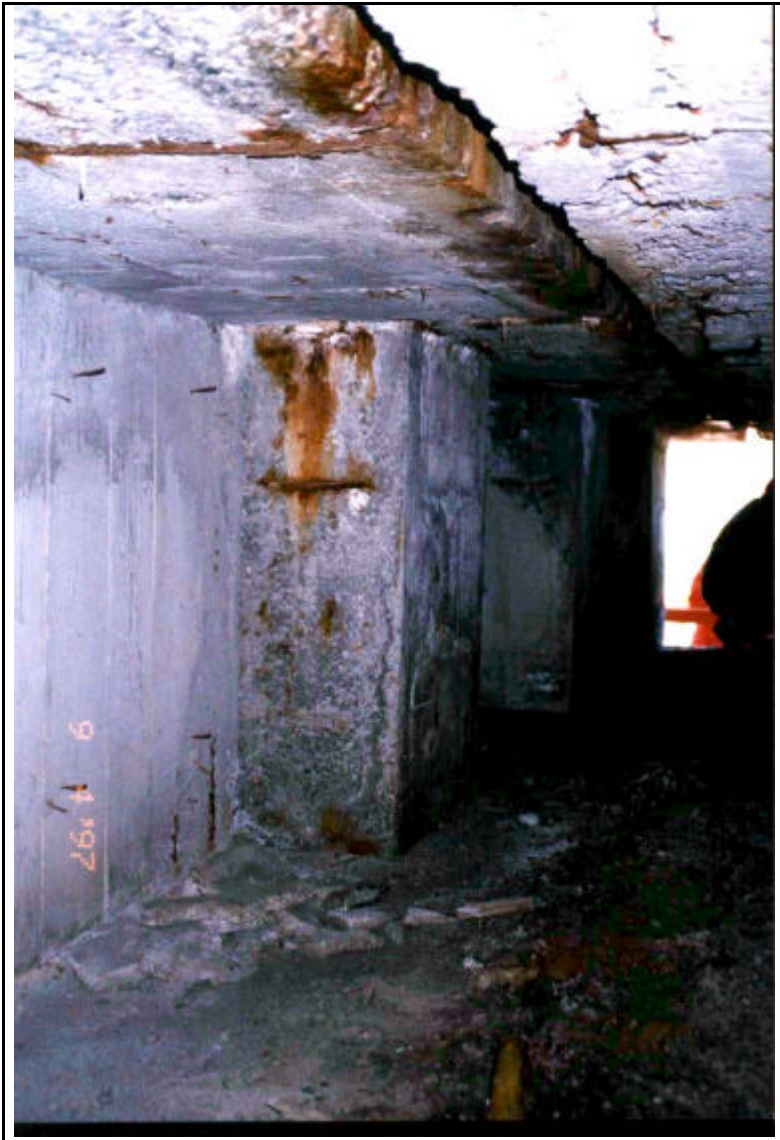
Fig. 1 - Corrosione sulla testata di una trave interna e sulla testata delle solette
