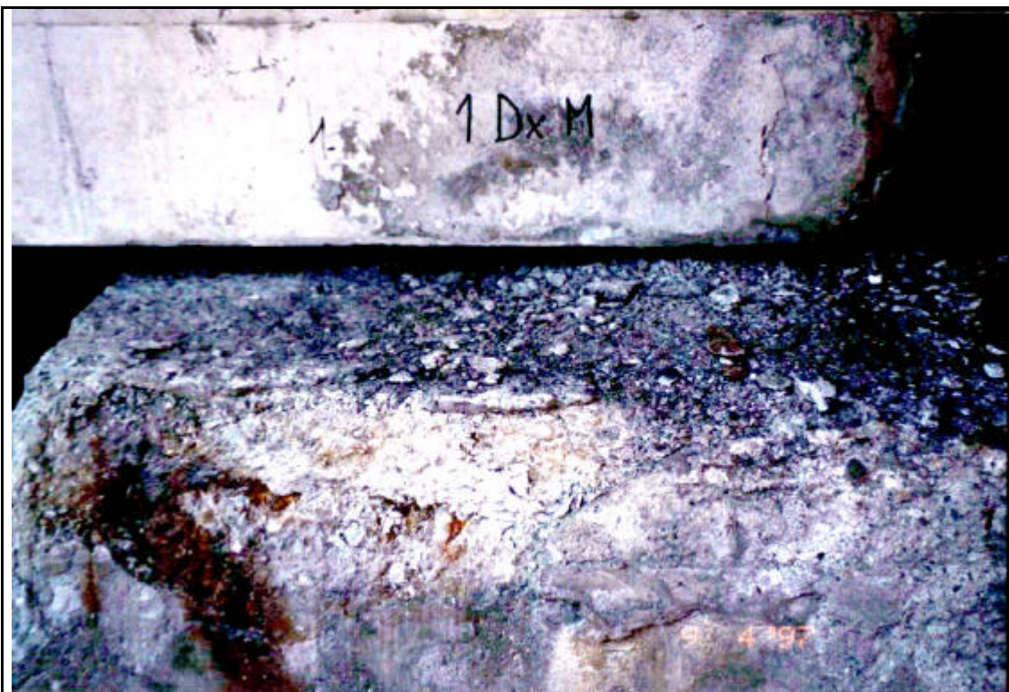
Fig. 3 - Degrado del pulvino dovuto a fenomeni di gelo-disgelo ed azione dei cloruri
